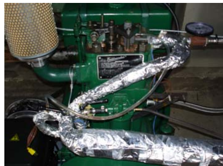
Circuit d'huile de palme chauffé et isolé
